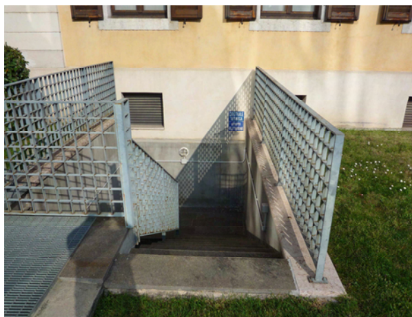
Scala verso la centrale termica e il locale per il gruppo elettrogeno
