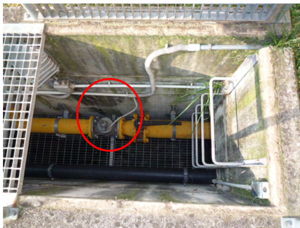
Pulsante per lo stacco del metano
