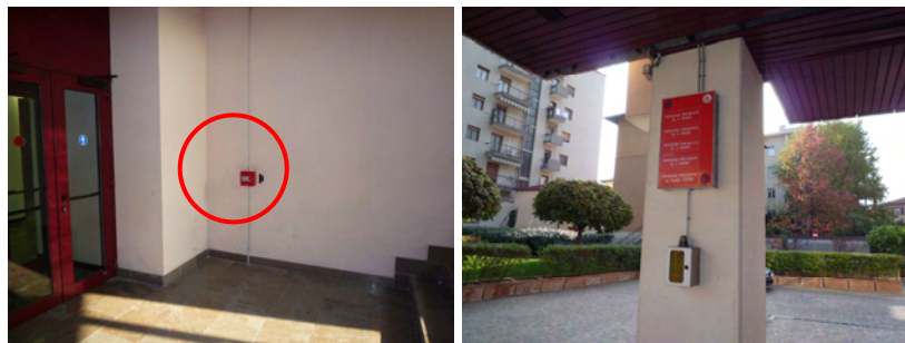
Pulsante di attivazione del segnale e pannello luminoso
