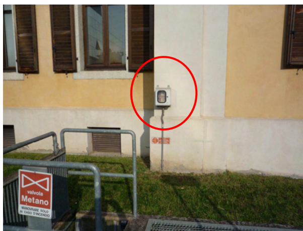
Sgancio corrente elettrica e gruppo elettrogeno
